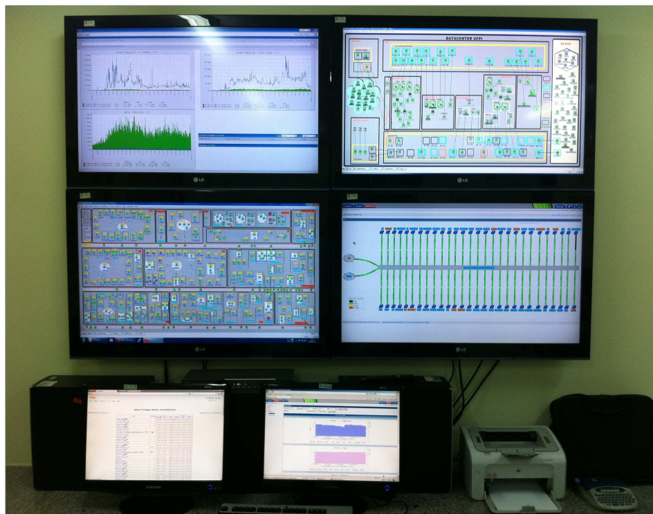
Ilustração 2: Central de monitoramento de rede
